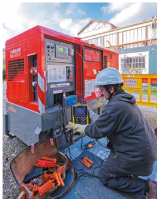
Stage distribution électrique, extérieur J.-George
