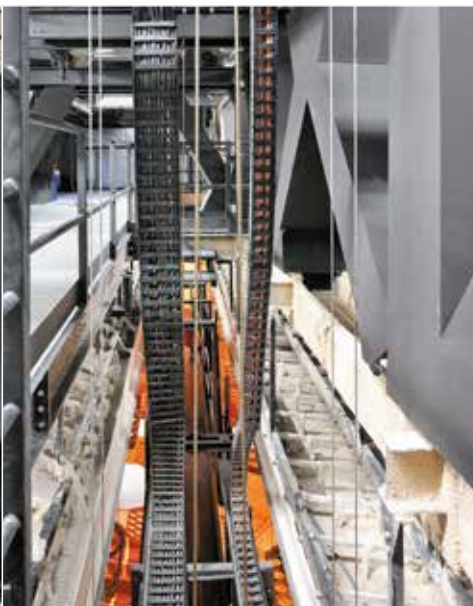
Chaînes d'alimentation (passerelles mobiles auditorium)
