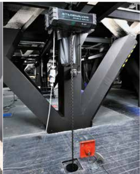
Ancrage au gril, palan électrique (auditorium)
