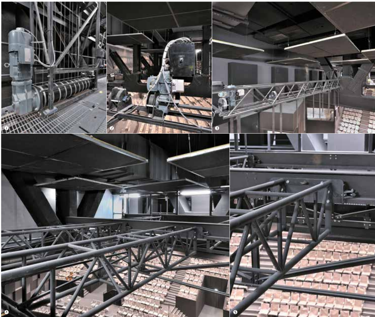
❶ Treuils à trançage AMG Féchoz (gril de scène GSA) ❷ Motorisation d'un enrouleur de réduction de jauge (GSA) ❸ Enrouleur de tenue de réduction de jauge (GSA) ❹ Couronne de poutres mobiles (gril de salle GSA) ❺ Crémaillères des poutres mobiles (GSA)
