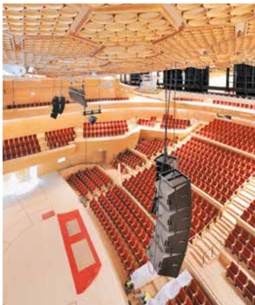
Renforcement sonore en place (auditorium)
