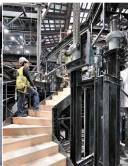
Plates-formes élévatoires, escaliers (avant-scène GSA)
