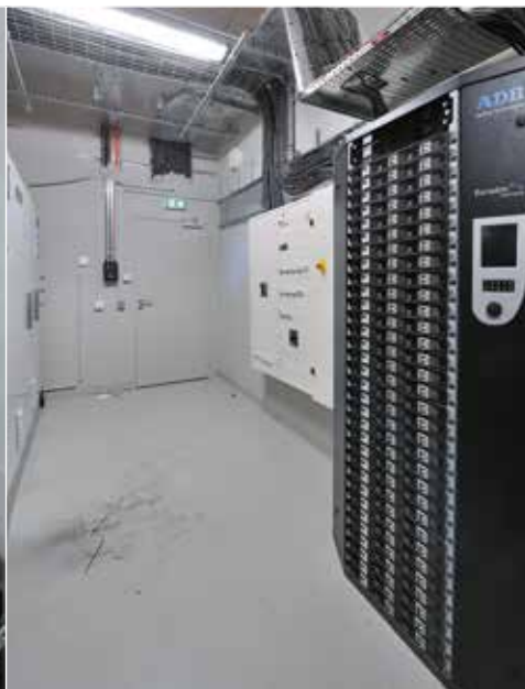
Armoires de gradateurs (MHS17)
