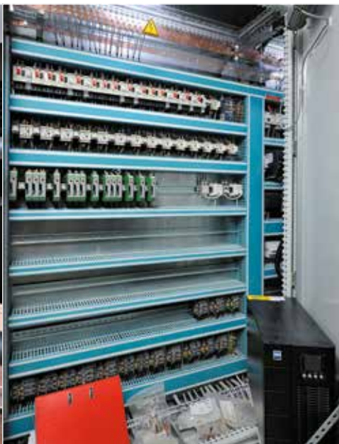
Armoire de commande de machinerie (MHS17)
