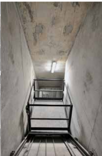
Plate-forme lift motorisée AMG Féchoz (auditorium)
