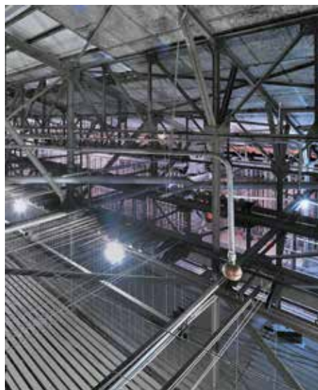
Déluge de scène (dispositif hydraulique) au-dessus du gril de charge
