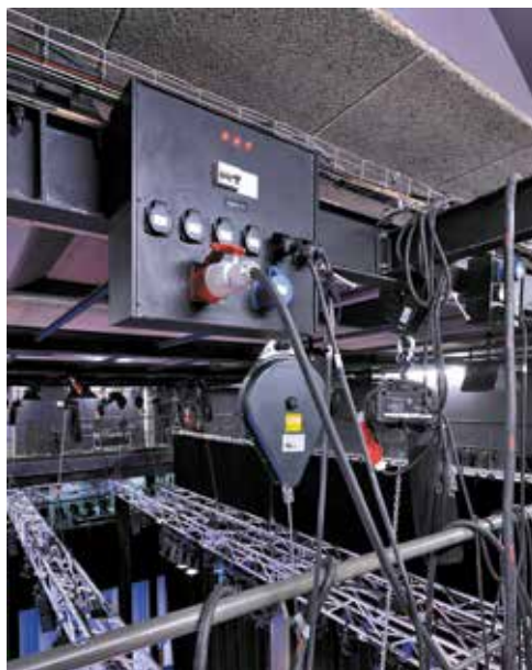
Boîtiers réseaux éclairage scéniques, griffes, palans électriques, dispositifs anti-chutes de charge (l'Embarcadère)
