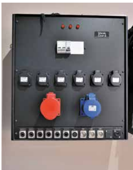
Boîtiers réseaux éclairage scéniques
