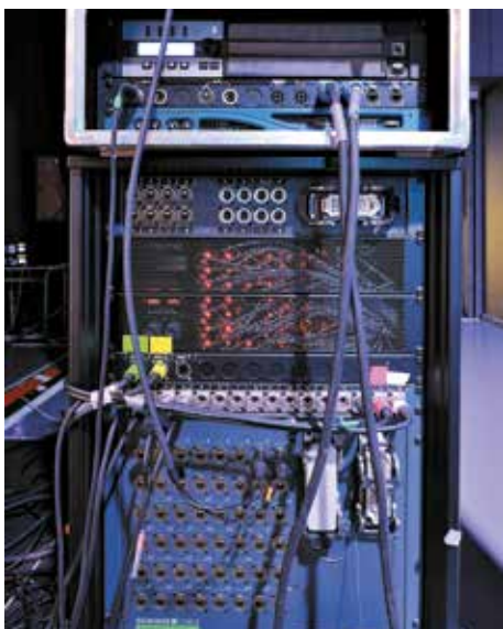
Rack audio mobile regroupant les patches de scène et les stage boxes déportées de la console façade Midas Pro2 (l'Embarcadère)
