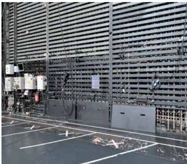
Cheminées de contrepoids, armoires électriques de tournée & trappes d'accès aux poutres libres
