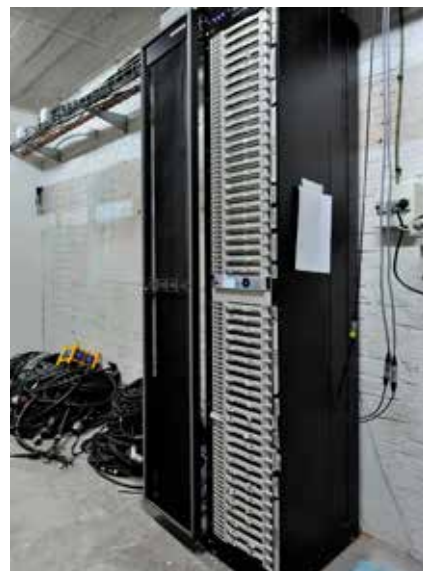
Armoire de gradateurs ETC Sensor3
