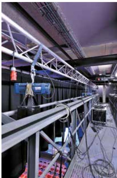
Ancrage de la diffusion sonore (1 ère passerelle) : palans électriques Donati, poutre fixe Stacco série 300
