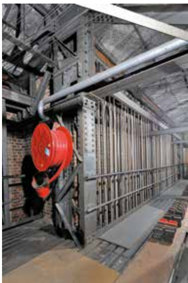
Charge au gril côté cour au niveau de la zone de marche
