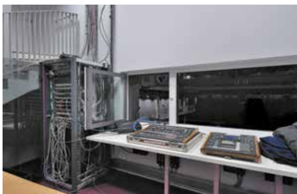
Régie fermée, baie audiovisuelle (salle de l'Embarcadère)
