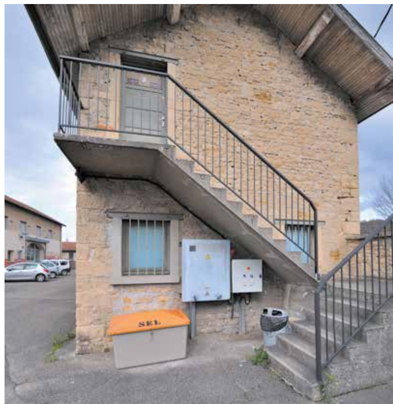
Armoires électriques extérieures fixées au pignon des anciennes écuries
