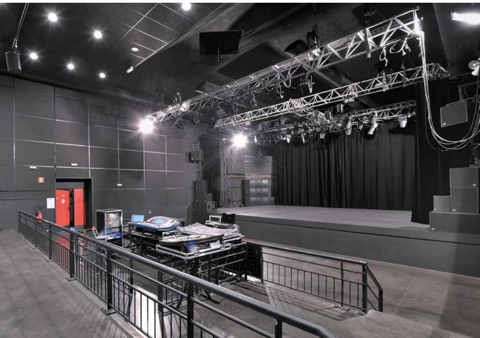
Régies en salle implantées au niveau de la 1 ère terrasse
