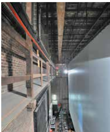
La passerelle de fond de scène, porte d'accès coupe-feu de la réserve à décors, le cyclorama
