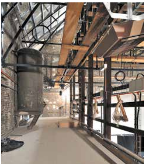
La passerelle latérale jardin, ancienne vessie du grand secours, plate-forme d'accès aux ponts de singes
