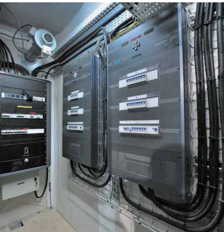
Local TGBT scénique avec accès direct à la scène, armoires de gradateurs ADB Eurorack 60 Wall Mounting
