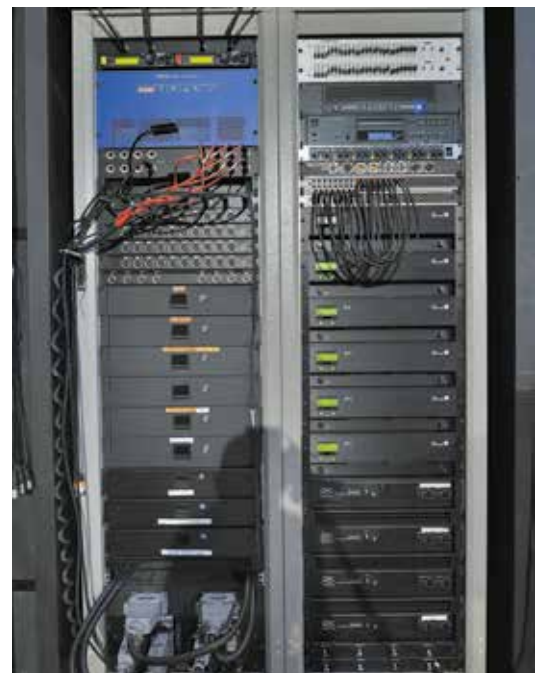
Baies audio comprenant les stage boxes, le contrôle, l'amplification façade et retour
