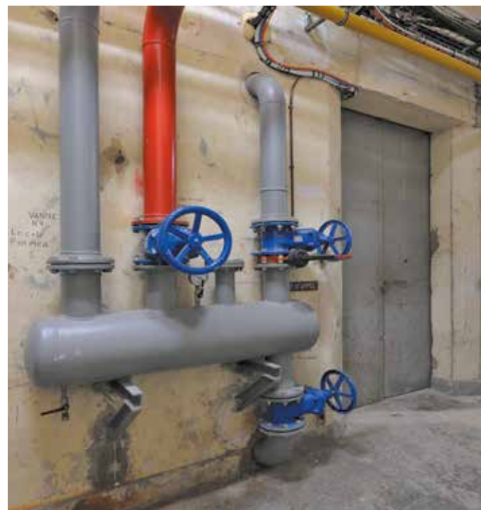
Le grand secours rénové et raccordé sur le réseau d'incendie urbain (grand couloir)
